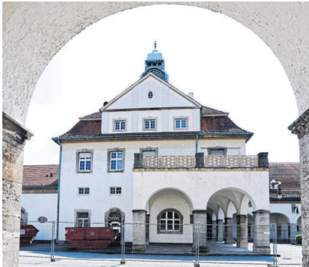
Bei der Sanierung des Badehauses 5 muss insbesondere auf den Denkmalschutz und auf das korrekte Entfernen und Entsorgen von Schadstoffen geachtet werden.
